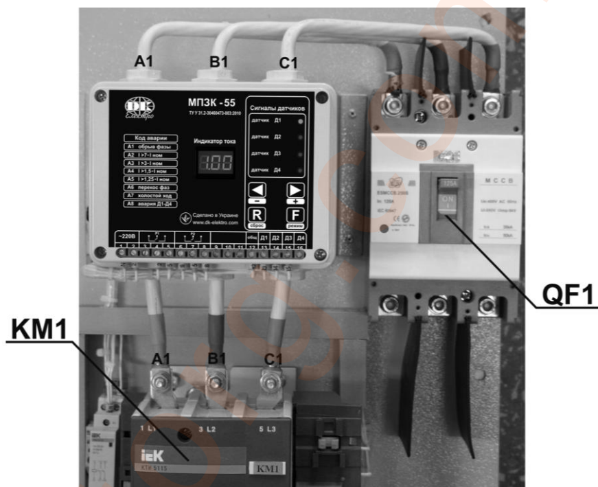
Фото 1. Подключение силовых проводников
